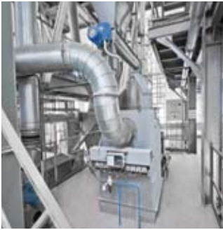
Рис. 13. Линия подготовки отрубей
