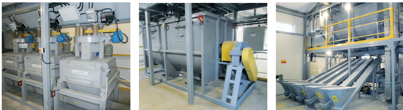
Рис. 1. Общий вид контейнеров с установленным технологическим оборудованием
