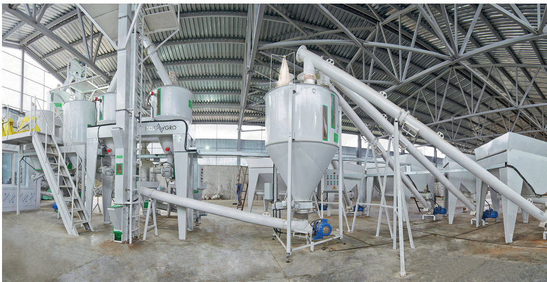
Внутри производственного помещения
