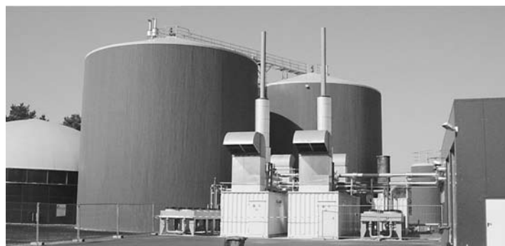
Рис. 2. Биогазовая установка производительностью 2,5 МВт в Вертеле (Германия)
