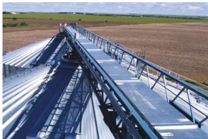
Закрытый ленточный конвейер
